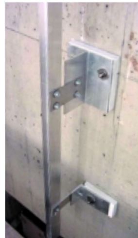
Links: Unterkonstruktion hinter der vertikalen Fuge – ohne Anker und Zierprofile und ohne Dämmung
